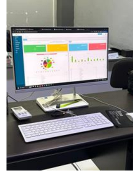
Gambar 2. Server dan Pusat Kendali AMR
