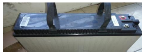
Gambar 7. Baterai 100 AH 12 Volt
