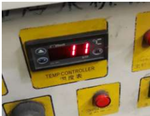
Gambar 10. Pengecekan suhu chiller.
