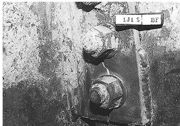
Gambar 6: Kerusakan fraktur vertikal pada sambungan balok akibat gempa Northridge (FEMA 2000)
