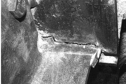
(a). Kerusakan pada transisi pengelasan
