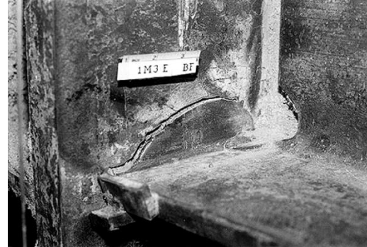
(b). Kerusakan "divot" pada sayap kolom
